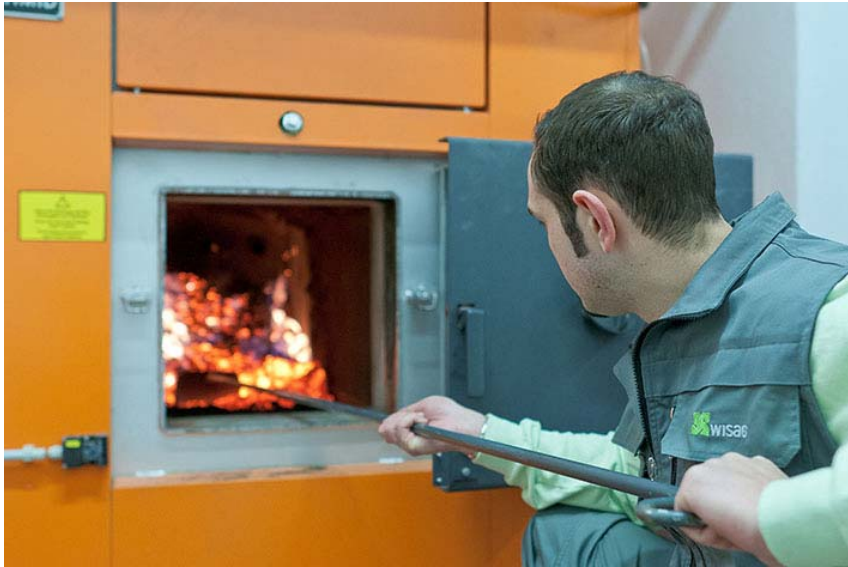
Sichtkontrolle in der Brennkammer eines Holzhackschnitzel-Heizkessels
